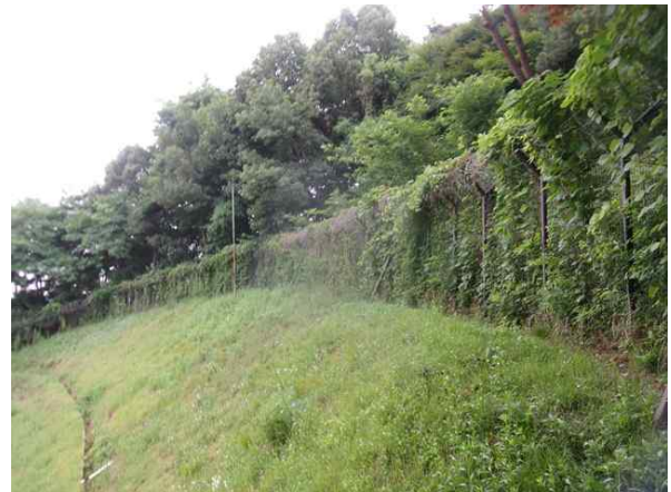
손상내용 안전웬스 상태양호 손상원인 -
