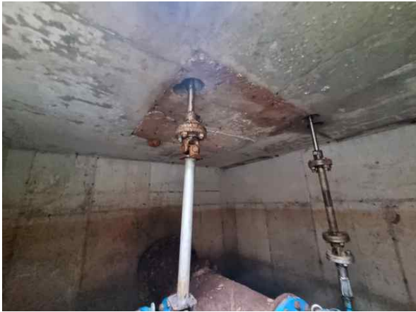
손상내용 유출밸브실 박리 손상원인 시공불량, 공용열화
