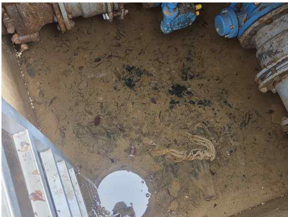
손상내용 유입유량계실 체수 손상원인 우수유입, 배수기능 저하
