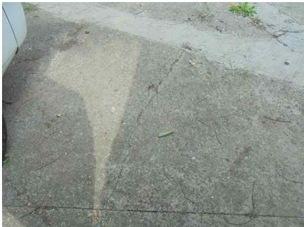
손상내용 콘크리트 포장 균열 손상원인 건조수축
