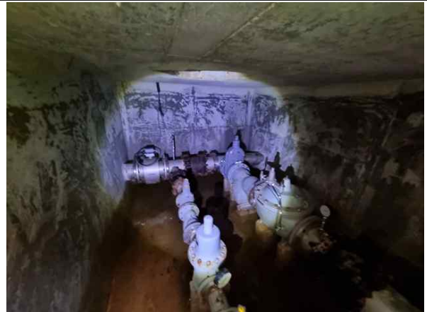
유출유량계실 내부 전경
