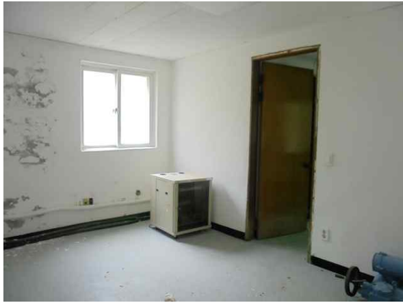
전기실 내부 전경
