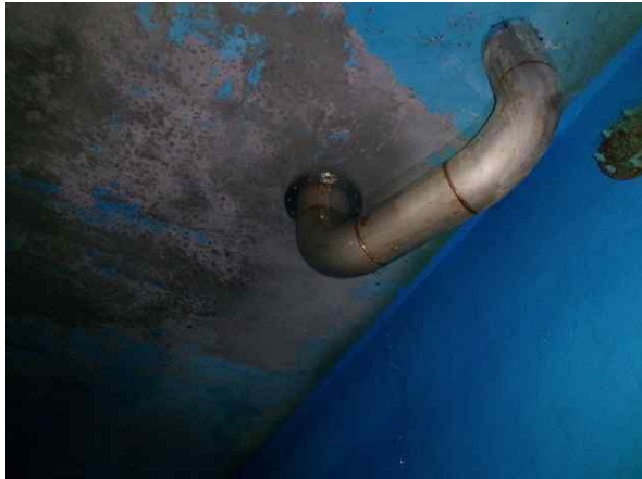
기계설비(2지 유입 배관)
