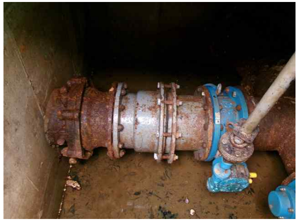
손상내용 유출밸브실 배관부식 손상원인 공용열화
