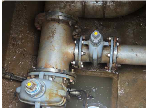
손상내용 유입유량계실 배관부식 손상원인 공용열화
