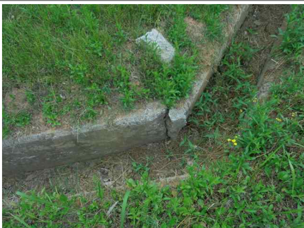
손상내용 배수로 파손 손상원인 시공미흡, 우수유입
