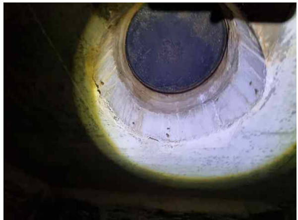
손상내용 유출유량계실 잡철물 노출 손상원인 시공불량
