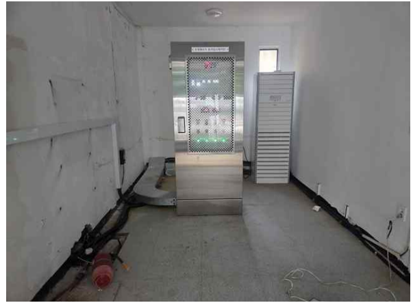
전기실 내부 전경
