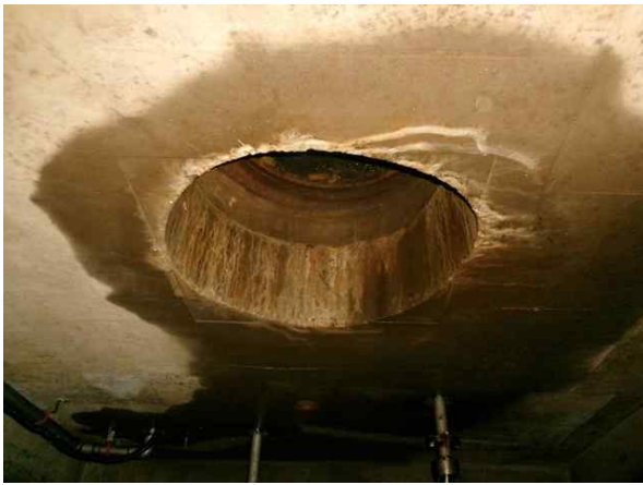
손상내용 유입밸브실 상부슬래브 백태 손상원인 습윤침투
