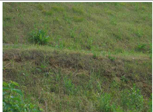
손상내용 사면 침식 손상원인 시공미흡
